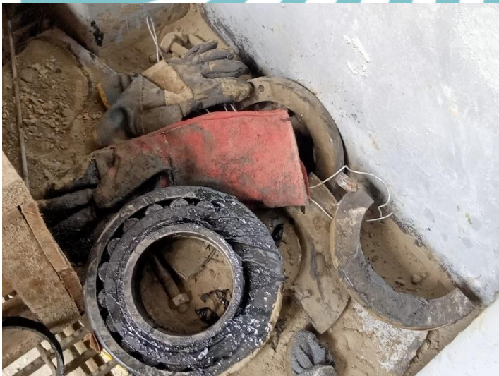
Gambar 1. 2 Kerusakan pada bearing Intermediate shaft cooler
