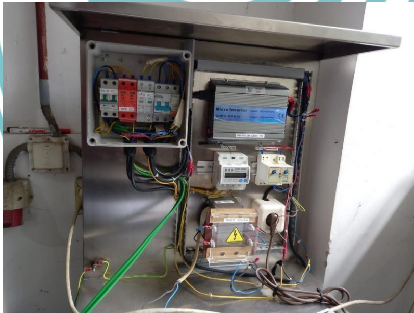
Gambar panel desk sebelum direkonstruksi
