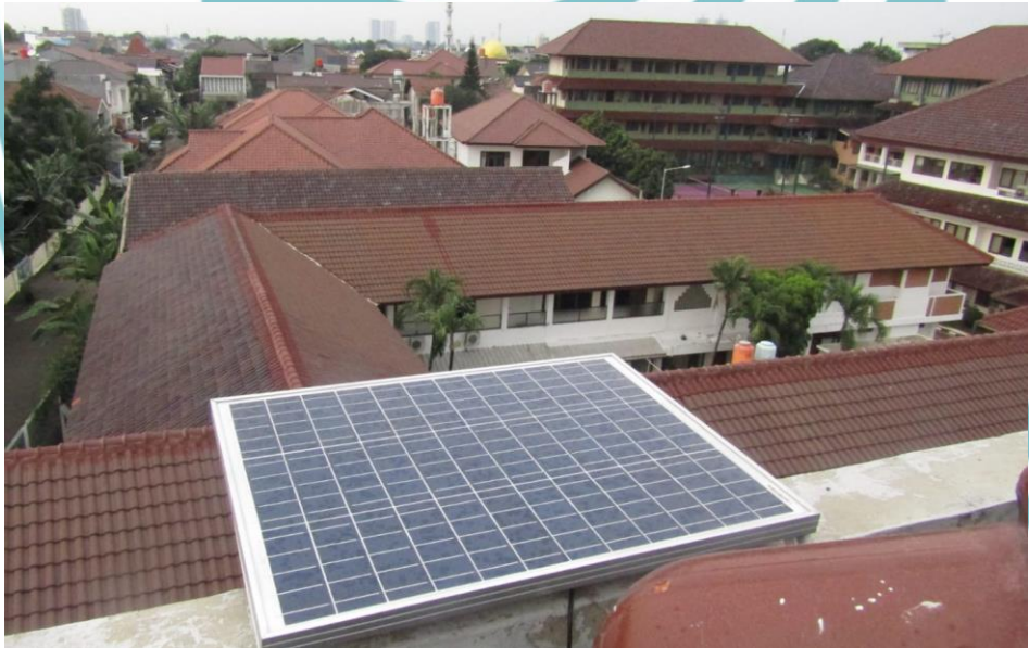
(Dokumentasi Panel Surya 50 Wp Terpasang)
