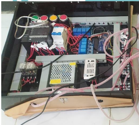
Gambar L.2 Tampak dalam panel
