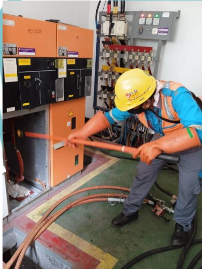
Gambar 3. 78Pengeckekan tegangan kubikel
