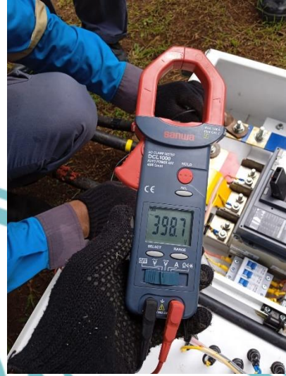
Gambar 3. 81 Pengukuran tegangan pada panel sinkron
