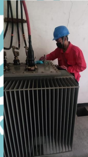
Gambar 3. 87 Pemeliharaan pada bagian transformator
