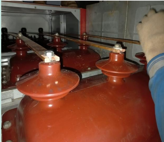
Gambar 3. 88 Pemeliharaan bagian busbar
