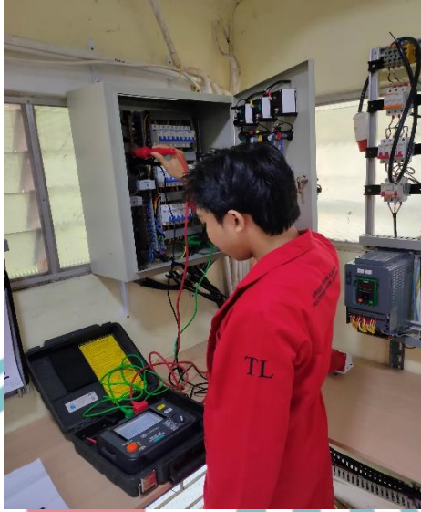
Lampiran 2.1 Pengujian Tahanan Isolasi pada Power Panel
