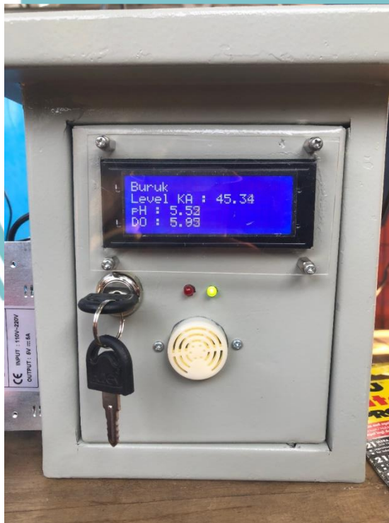
Foto 2. Tampak Luar Box Panel
