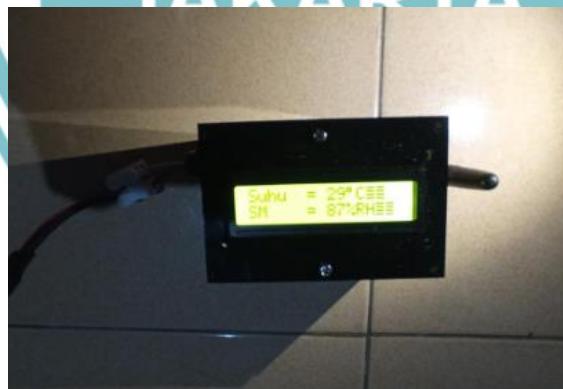
Gambar L- 3 Instalasi Panel 2 (RX)
