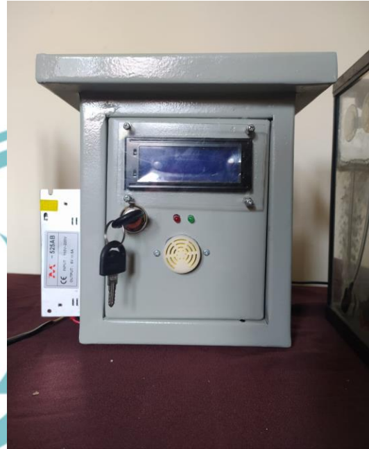
Foto 2. Kondisi Panel Tertutup
