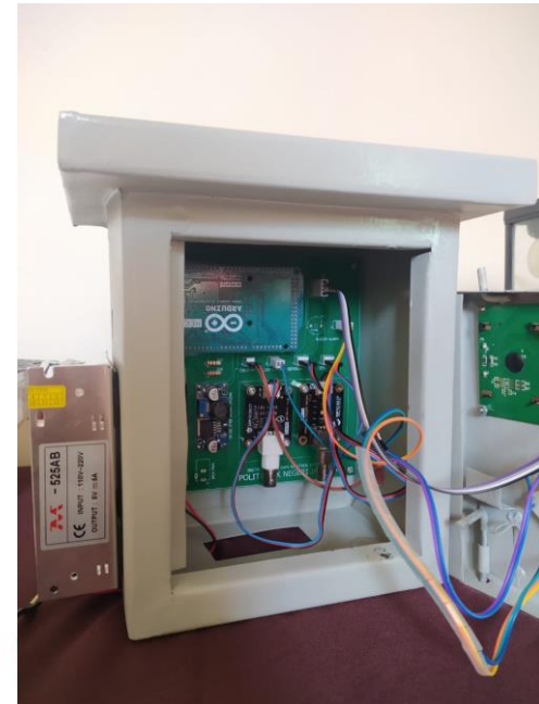
Foto 1. Kondisi Panel Terbuka
