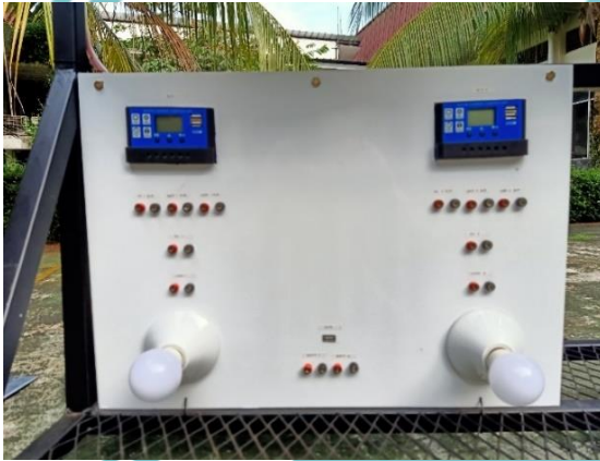
Papan terminasi tampak depan
