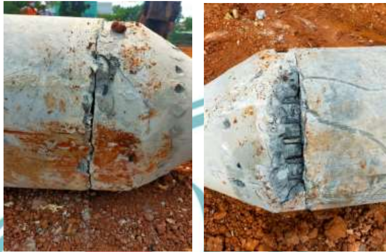
Gambar 4. 5 Retaknya Spun Pile
