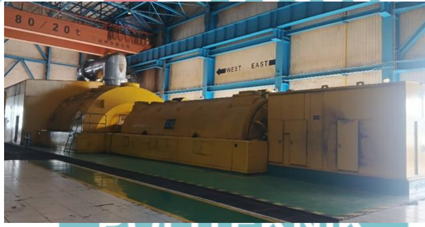
Gambar 2. 3 Generator Sinkron (sumber :Dokumentasi Pribadi)
