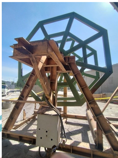
Gambar 1. 1 Kondisi bagian luar panel kontrol lama mesin belt winder (Sumber: Dokumentasi pribadi)
