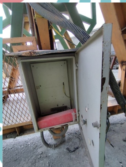
Gambar 1. 2 Kondisi bagian dalam panel kontrol lama mesin belt winder (Sumber: Dokumentasi pribadi)
