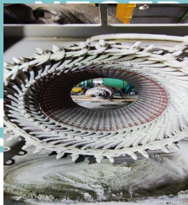
Gambar 3. Kondisi Coil Motor Eksisting Akibat Akumulasi Debu
