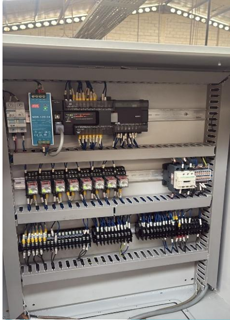
Foto Realisasi Panel Kontrol
