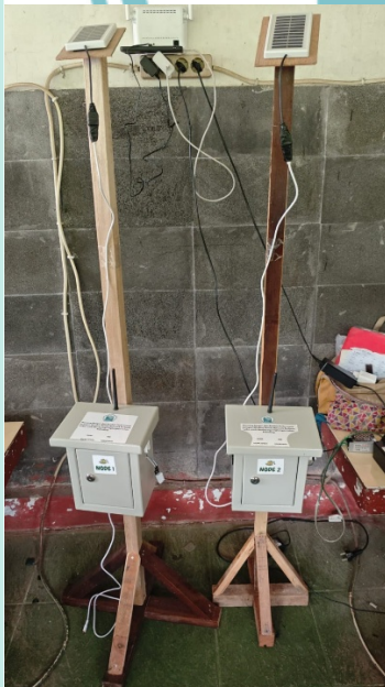
Lampiran 8. Node 1 dan 2 dengan Panel Surya dan box panel
