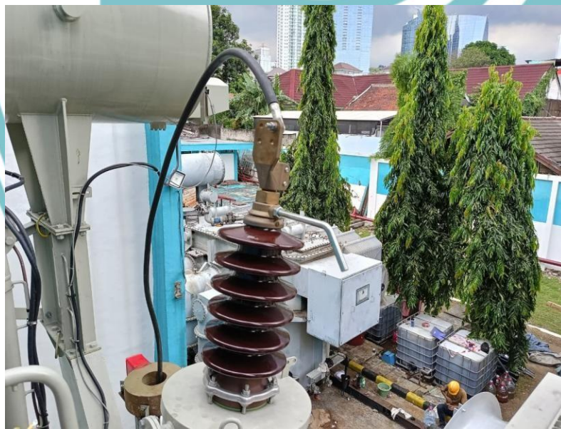
Lampiran 2 Pergantian Trafo 1 GIS 150kV Setiabudi.
