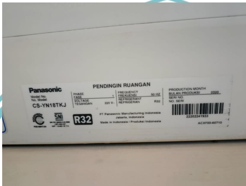
Lampiran 38 Unit AC di Ruang Rias Wanita
