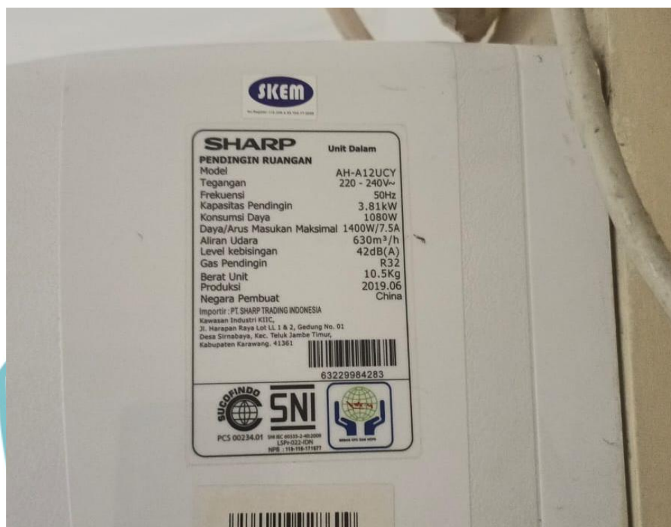
Lampiran 42 Unit AC di Ruang Rias Pria
