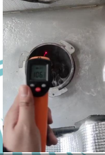
Pengecekan Fungsi Heater Listrik
