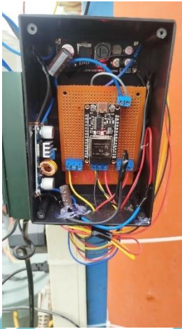
Wiring dan Box Panel
