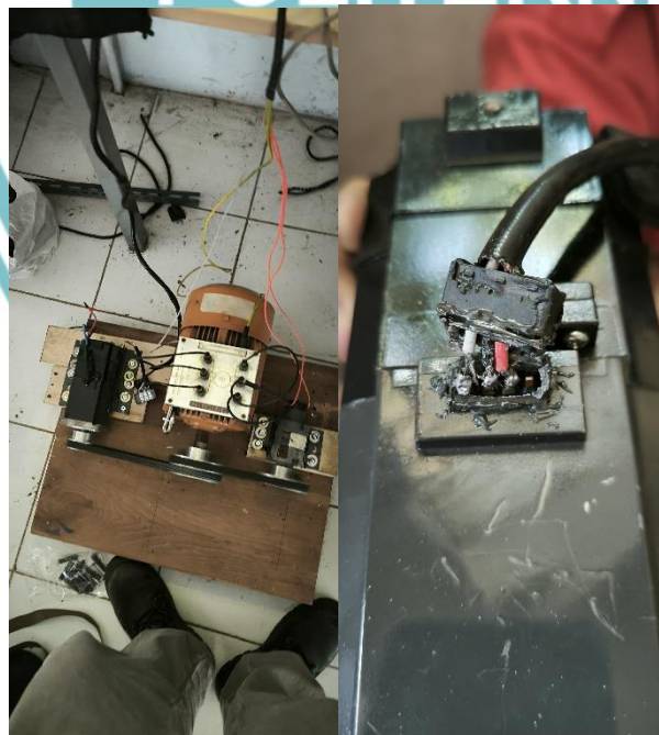
Dokumentasi 2 Penampakan mekanik kopel motor (kiri), generator yang harus diperbaiki (kanan)
