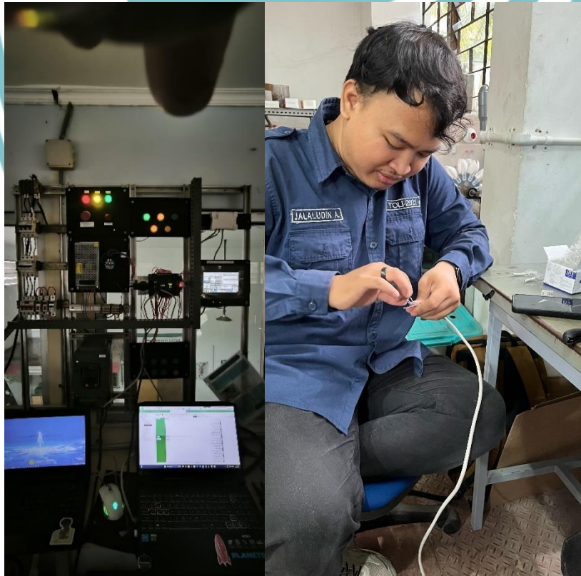
Dokumentasi 6 penampakan panel kontrol alat (kiri), penyambungan konektor rj45 ke kabel ethernet (kanan)
