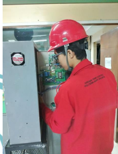
Pengecekan Berkala Pada Panel
