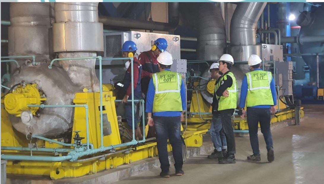
Pengecekan vibrasi dan suhu pada BFPT (Booster Feed Water Pump Turbine)
