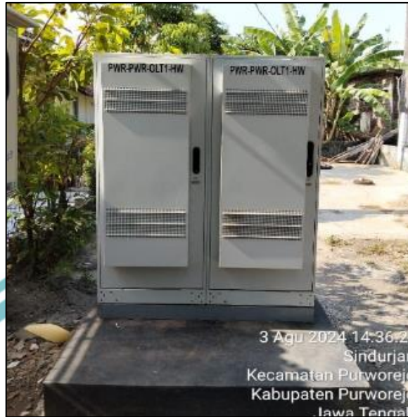
Gambar 2. 7 Contoh Instalasi ODC dan OLT Sumber: Dokumentasi PT Eka Mas Republik
