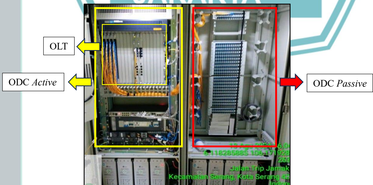
Gambar 3. 13 Instalasi ODC dan OLT
