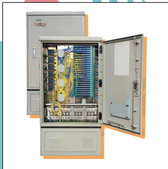
Gambar 2. 2 Optical Distribution Cabinet (ODC)
