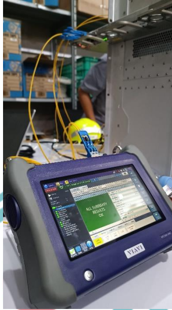
Gambar L. 3 Pengujian BER untuk staging DWDM
