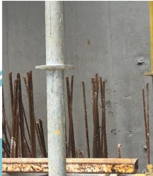
Gambar 3.44 Evaluasi terhadap Pekerjaan Retaining Wall
