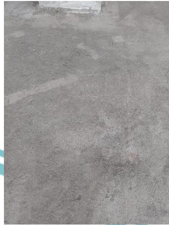
Gambar 3. 34 Retak Dekat Area Kolom
