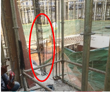
(Besi kolom yang bermasalah)
