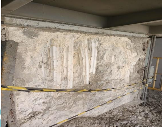
Gambar 1.1 Kondisi Bag Mengeras pada Compartment 532-BF3
