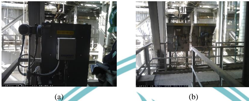
Gambar 1. 1 O_2 Analyzer pada Boiler Modul II PT Badak NGL (a) Satu Unit Pada Boiler 24 (b) Dua Unit Pada Boiler 26 Sumber: Observasi Lapangan
