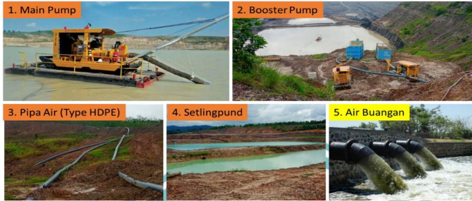
Gambar 1.2 system dewatering di tambang batubara
