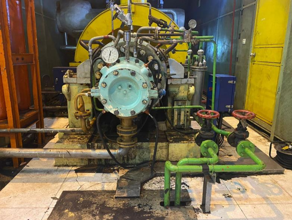
Tampak depan pompa BFPT
