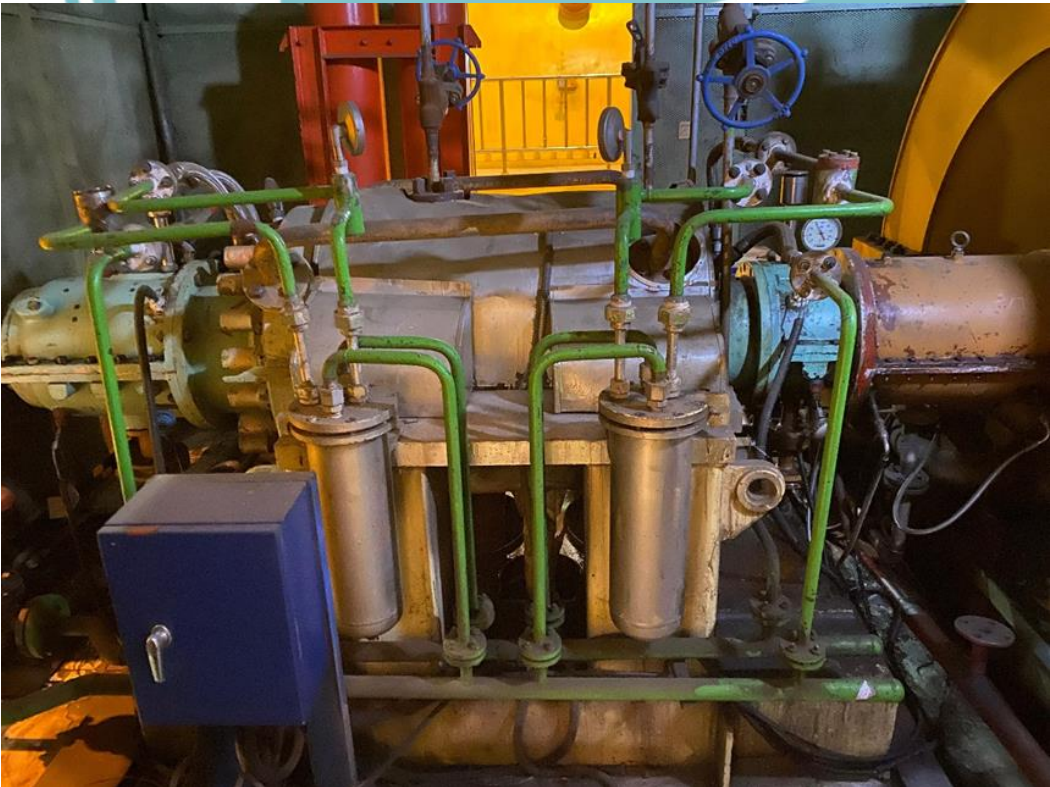
Tampak Pompa dari samping
