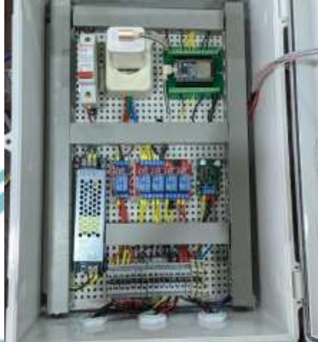
Wiring Control pada Panel
