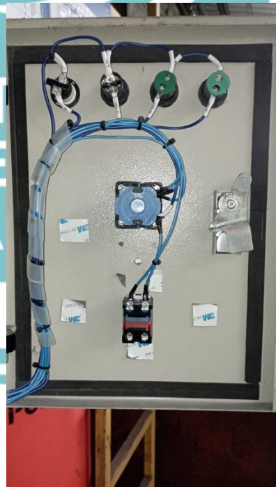
Tampak Pintu Panel
