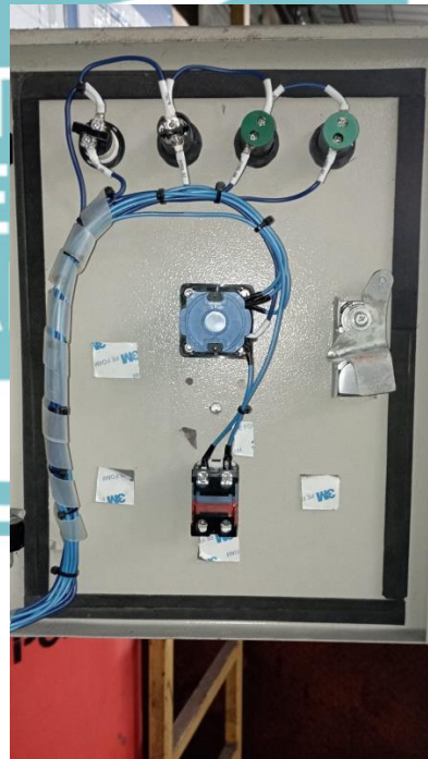
Tampak Pintu Panel
