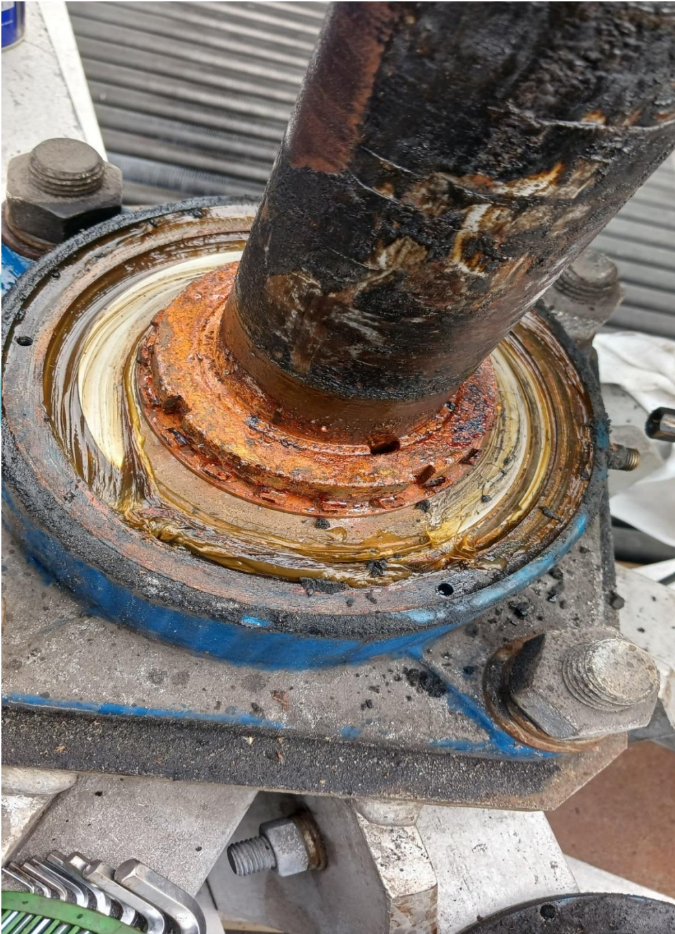
Lampiran 4 Penyebab terjadinya Vibrasi Tinggi pada Bearing
