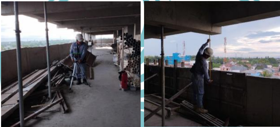
Gambar 4. 7. Pengecekan Penurunan Lantai Cantilever Sumber: Dokumen Pribadi
