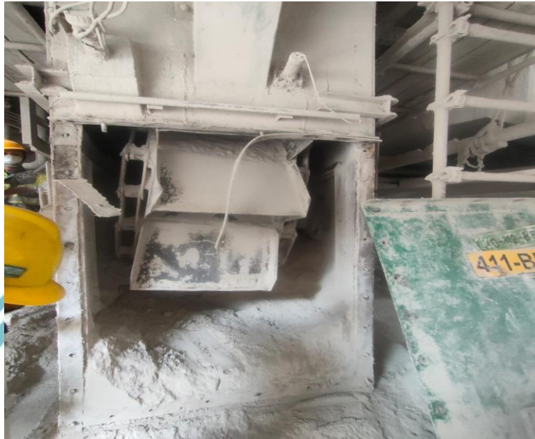
Gambar 1.1 Blocking pada inlet Bucket Elevator
