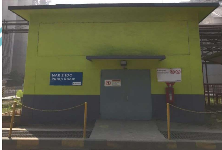
Gambar 1. 3 Ruang pompa solar NR2
