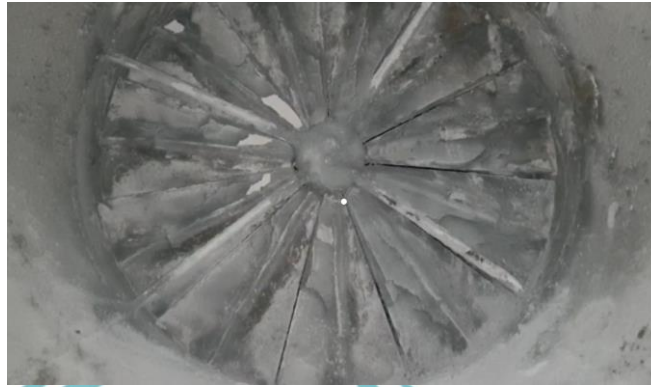
Gambar 1. 1 Damper booster fan (FA13)
