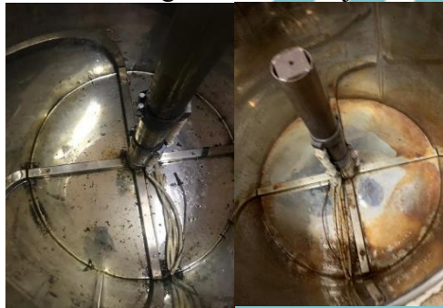
Terjadi penggenangan kondensat pada bagian bawah yang menyebabkan oven menjadi korosi
