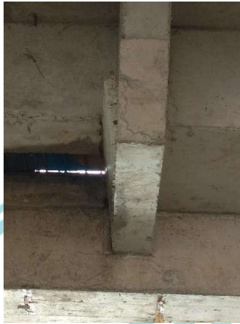
Gambar.0.1.1 Beton Tidak Rata (Plin) Sumber : Data Proyek
