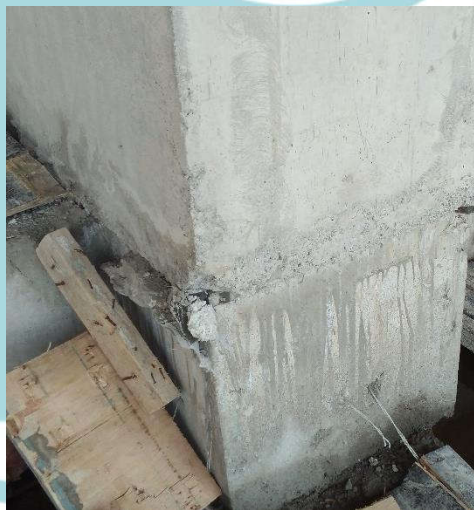
Gambar 1.0.2 Beton Keropos Sumber : Data Proyek
