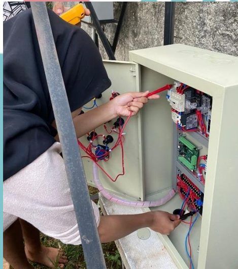
Lampiran 1. 4 Pengujian Wiring Betegangan AC 220V dan DC 12V
