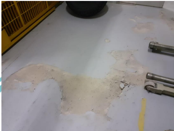
Lampiran 7 Kondisi Lubang pada Drum test II
