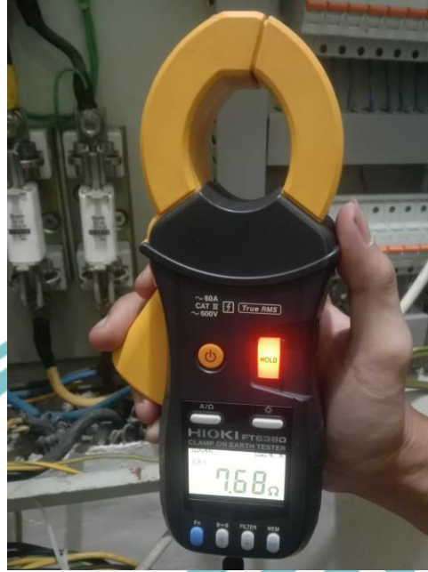
Gambar 4. 5 Grounding Pada PHB-TR
