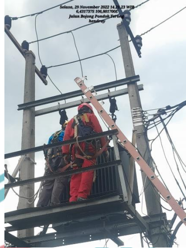
Gambar 2. 2 Jaringan Tegangan Menengah
