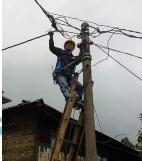
Gambar 2. 3 Jaringan Tegangan Rendah
