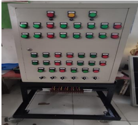
Tampak depan panel di atas rangka
