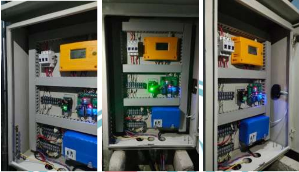
Penampakan dalam box panel kontrol tampak samping dan depan.
