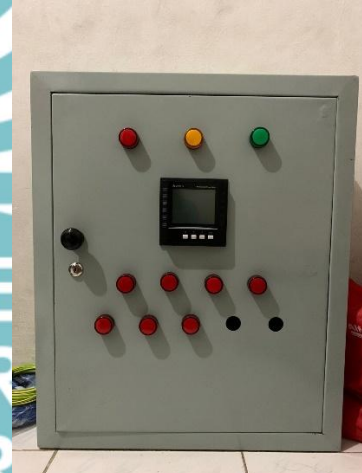
Lampiran 12 Bagian panel tampak depan
