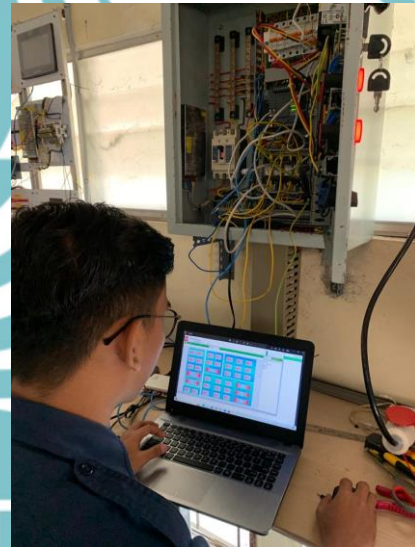
Pengambilan Data Menggunakan Monitoring SCADA
