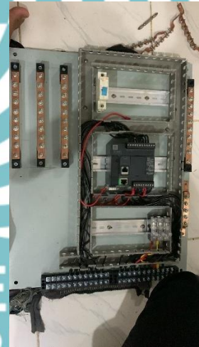
Progres wiring alat tugas akhir
