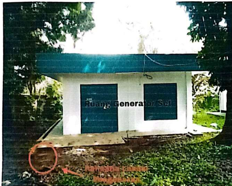
Gambar 2. Ruang Generator Set Politeknik Negeri Jakarta
